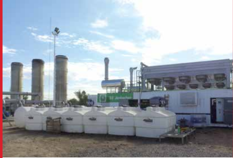
Foto: Planta de biogas San Martin CEAMSE. Gentileza del Minem.
